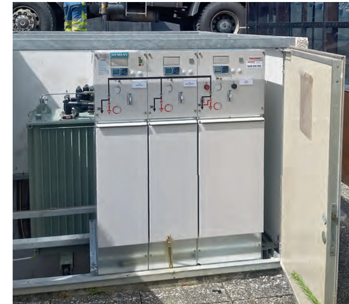
Laupersdorf hat drei neue Trafo-Stationen: Breitackerweg, ...
